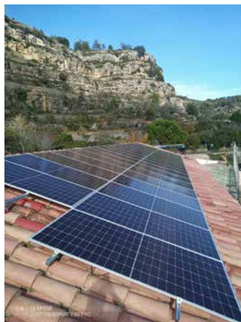
Panels solars per al pavelló
