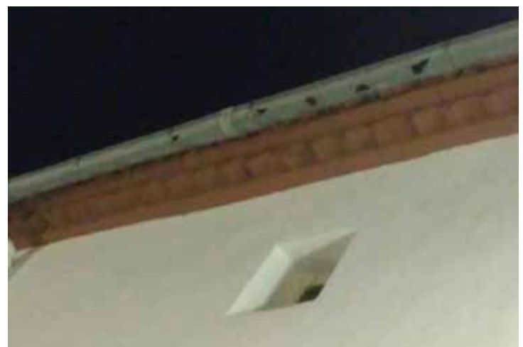
La pedregada del passat 20 de juliol va provocar danys a les canals
